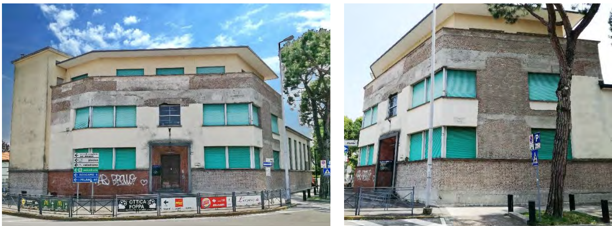
Fig. 5. Il Dopolavoro nelle condizioni attuali. Presunte esigenze di sicurezza hanno portato alla rimozione del rivestimento in klinker del basamento e alla demolizione di intonaci ammalorati.
